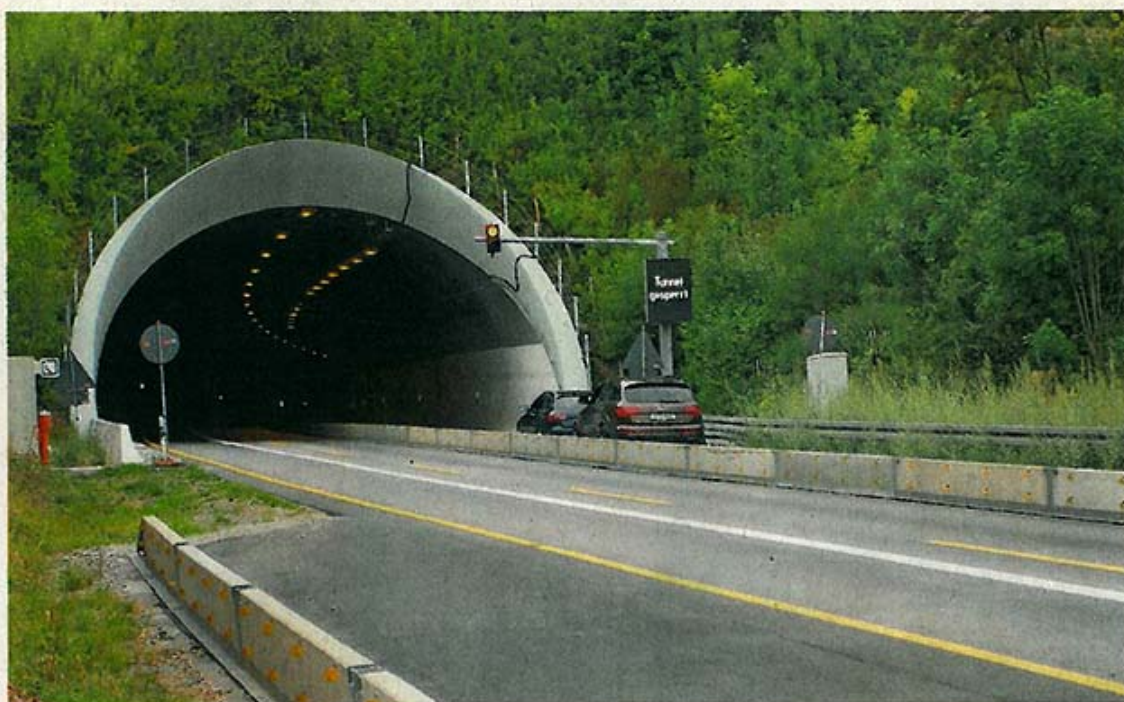
Kurzzeitige Sperrungen während der Sanierung des Schönbuchtunnels waren die Ausnahme. FOTOS: REGIERUNGSPRÄSIDIUM STUTTGART
